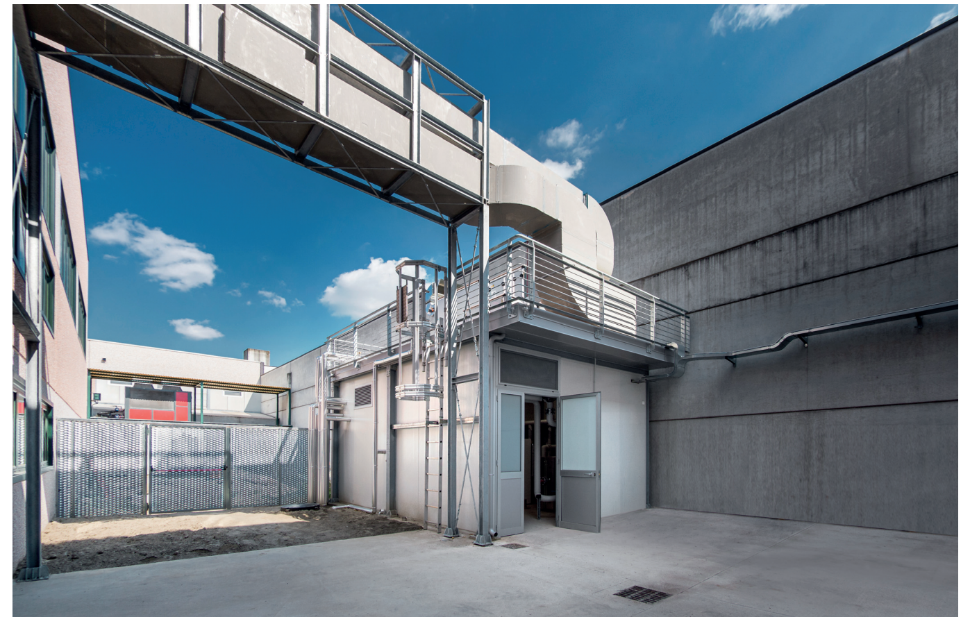
Impianto geotermico sito nella sede Pattern a Torino
